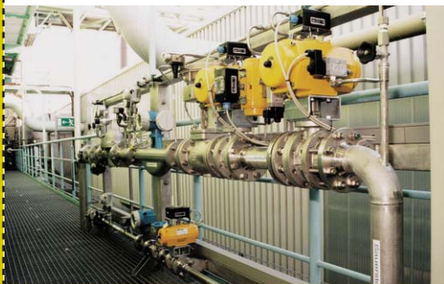
Anlage zur Regelung der Sauerstoffeinspeisung
